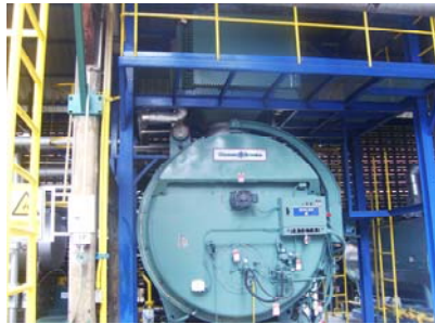
รูปที่ 2 เครื่องแลกเปลี่ยนความร้อนที่ติดตั้ง
