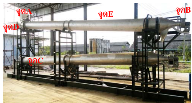
รูปที่ 5 ตำแหน่งตรวจวัดที่เครื่องอบแห้งปุ๋ยแบบหมุน
