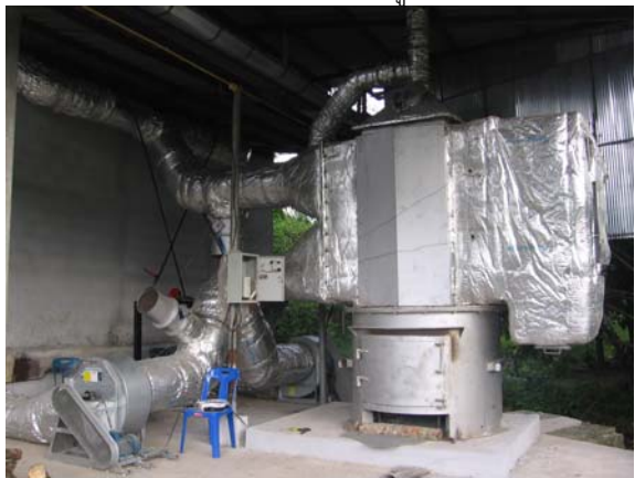
รูปที่ 5 เตากำเนิดความร้อนที่ติดตั้งในสหกรณ์การเกษตรพรหมคีรี จังหวัดนครศรีธรรมราช
