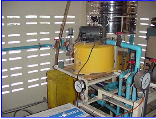
รูปที่ 24 การทดลองวัดค่าสมรรถนะของปั้มน้ำเพื่อหาค่าประสิทธิภาพ ก่อนและหลังการปรับปรุง
