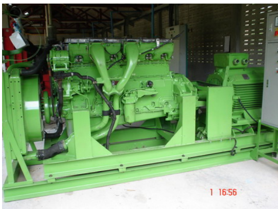
รูปที่ 2 เครื่องปั่นไฟแบบที่ใช้ Induction Motor ขนาด 120 kW
