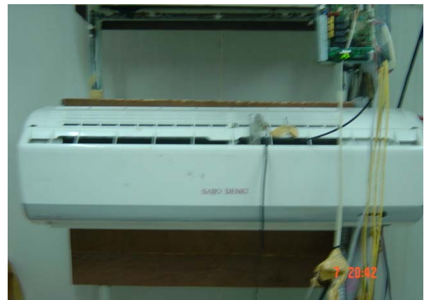
รูป 6 เครื่องปรับอากาศ
